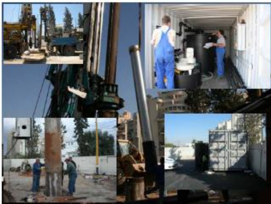
איור 9: מערכת טיפול בזיהום דלק במי תהום בתחנת פז קיבוץ גלילות בשיטת באר סיחרור
